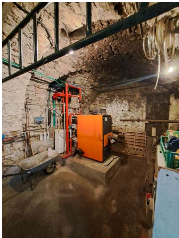
Figura 23 – cantina – caldaia a legna
